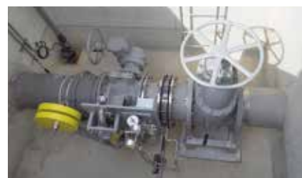
▲低区配水池緊急遮断弁
