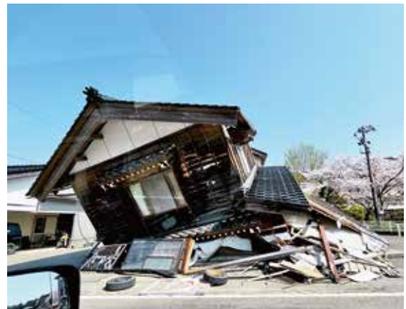
能登半島地震で倒壊した木造住宅 (撮影：町災害派遣職員)
