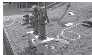
▲耐震性貯水槽（笹尾中央公園）
