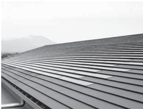
役場西庁舎屋上の太陽光パネル
