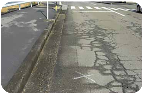
笹尾地区の傷んだ道路
