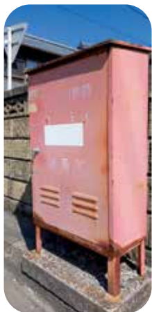
撤去してよいのか「格納箱」
