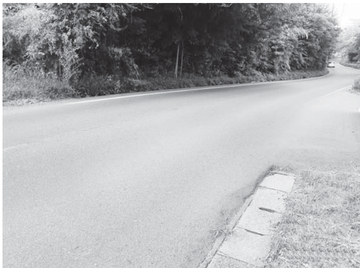
車線が見えないので危険（弁天山2号線）
