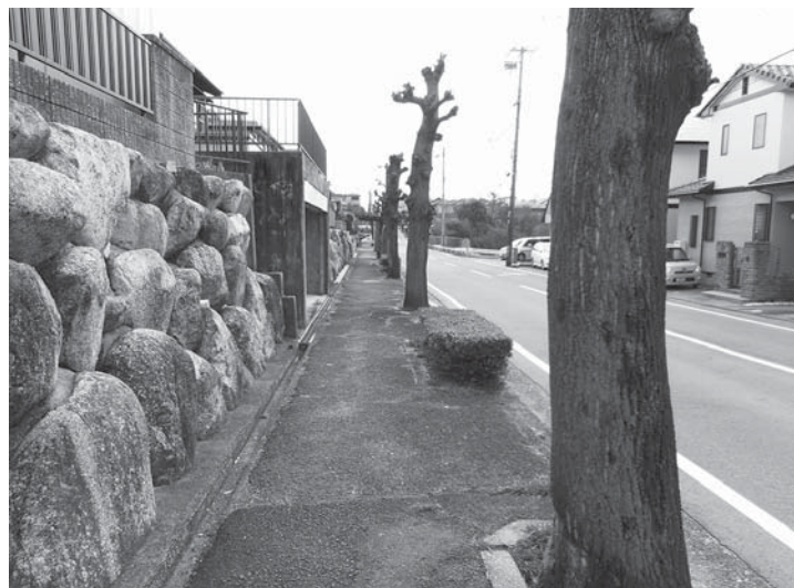
改修が待たれる歩道
