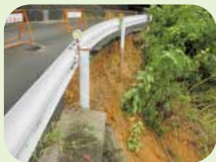
町内の土砂崩れ現場
