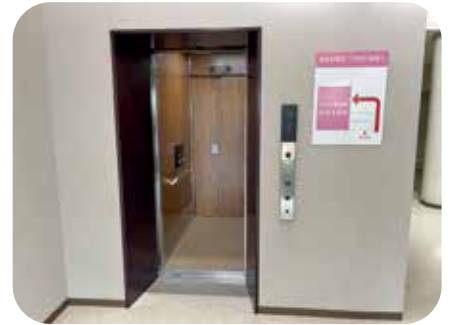
保健福祉センターに 新設したエレベーター
