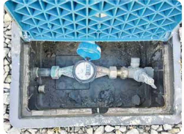
水道メーター
